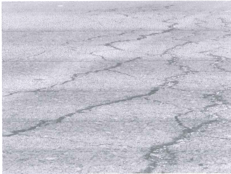
Resim 6.8. Blok (harita) çatlakları
