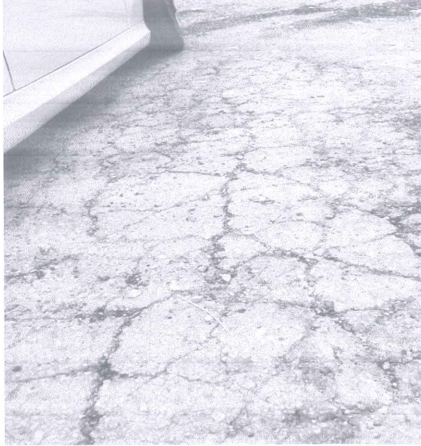
Resim 6.4. Timsah sırtı çatlaklar
