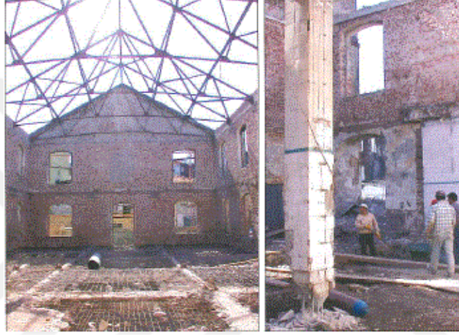
Resim 2.6. Kadir Has Üniv. C blok dış duvarlar içindeki betonarme strüktürün sökümü (Alper, 2019)
