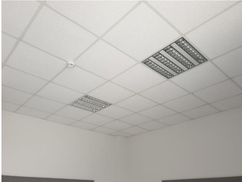
Resim 3.43. Toros Üniv. GSTMF B Blok stüdyo ve dersliklerde kullanılan yapay aydınlatma armatürü Foto: Tekin Banaz, 2020
