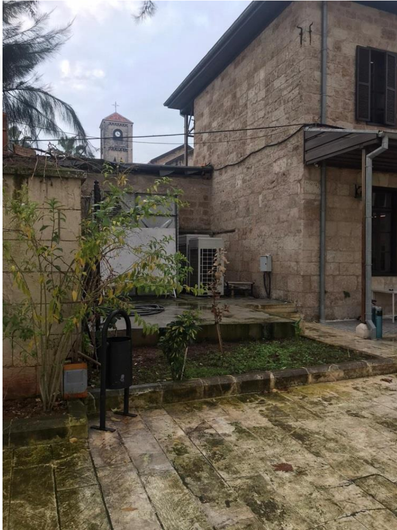
Resim 3.35. Toros Üniv. GSTMF A Blok avlusuna yerleştirilmiş VRF merkezi sistem kasaları ve yangın algılama sistemine ait su deposu Foto: Tekin Banaz, 2020
