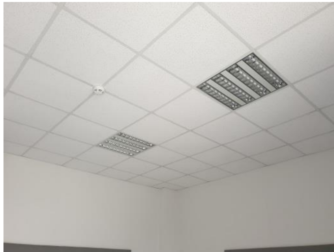
Resim 3.23. Toros Üniv. GSTMF B Blok Zemin kat B008 stüdyo Taşyünü Asma Tavan Kaplama Foto: Tekin Banaz,2020
