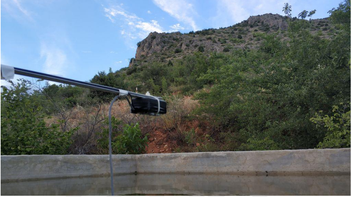
Şekil 4.8. Ultrasonik mesafe sensörü yerleştirilmesi
