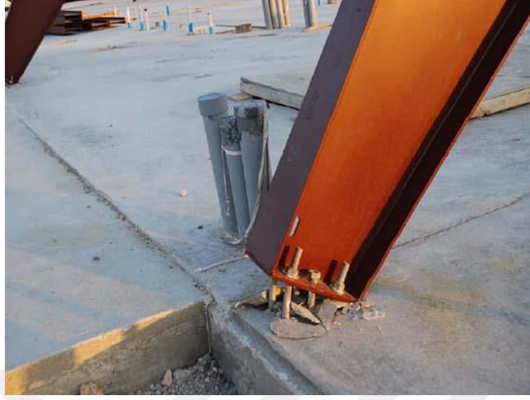
Şekil 5.2. Taban levhasının kullanılmaması ve birleşim elamanı yetersizliği sonucunda temel-kolon birleşiminde oluşan bozulma.
