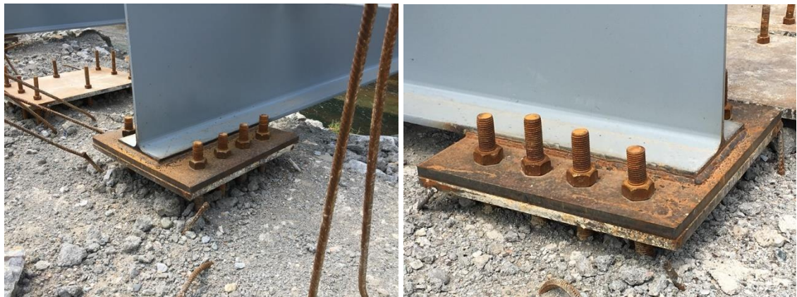
Şekil 5.7. Betonarme temel-çelik kiriş birleşiminde uygulama hataları.
