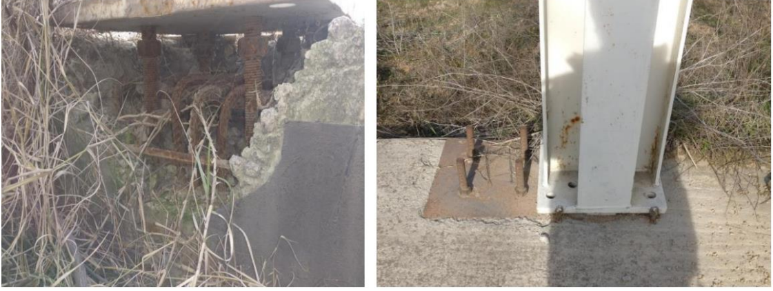
Şekil 5.4. Temel kolon birleşiminde hatalı uygulama.
