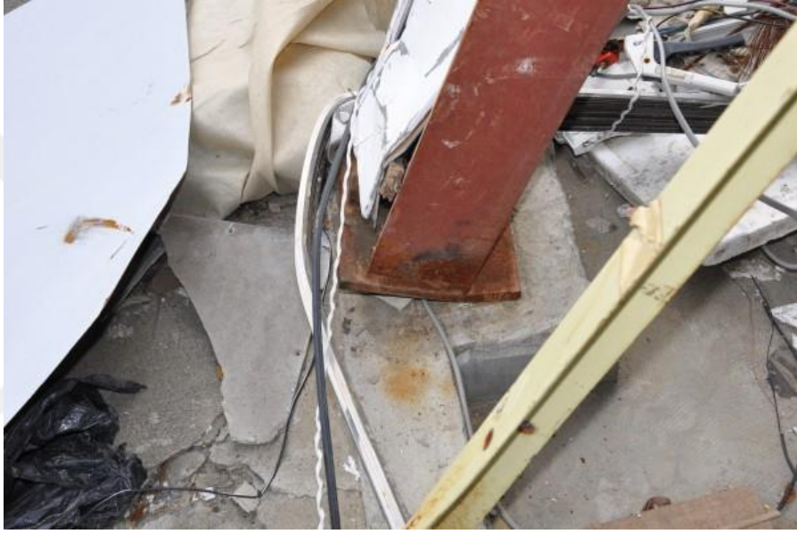
Şekil 5.1. Temel-kolon birleşim elemanlarının yetersizliği sonucu oluşan yapısal kusur.
