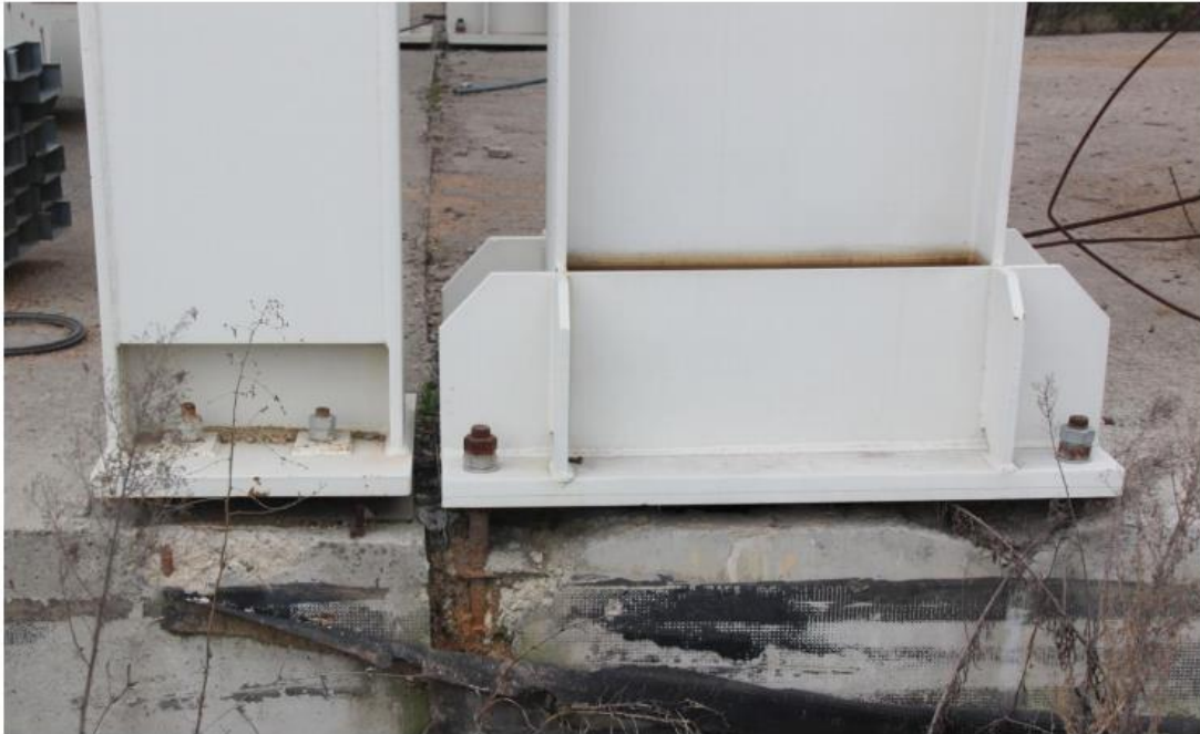
Şekil 5.5. Yetersiz temel uygulaması.
