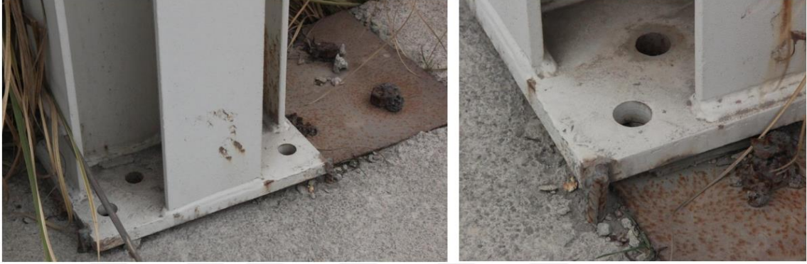
Şekil 5.6. Kolon temel birleşimi bağlantı elemanları hataları.
