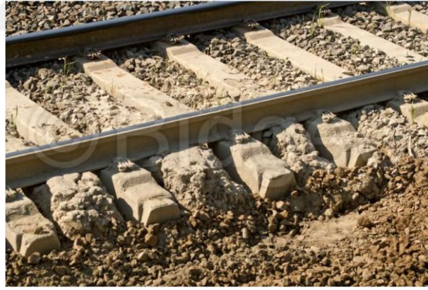
Şekil 2.65. Beton traversli zayıf zeminde tasman etkisi (Anonim-h, 2019)
