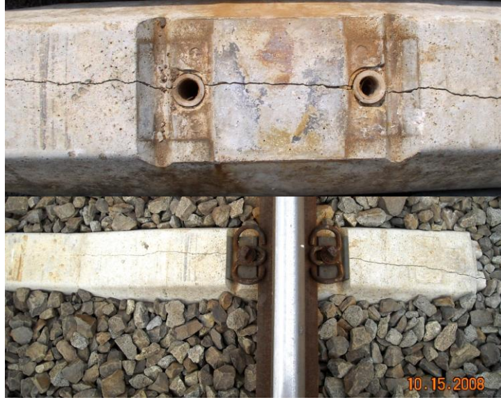
Şekil 2.66. Travers dübelleri arasında meydana gelen çatlamlar (Németh, 2016)
