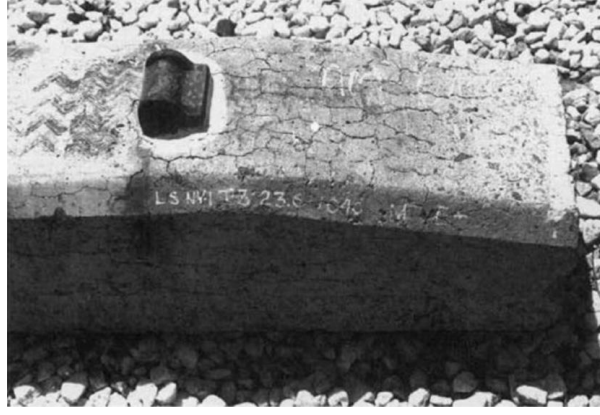
Şekil 2.63. Öngerilmeli beton traversde gecikmiş etrenjit oluşumu nedeniyle meydana gelen çatlamlar (Ferdous ve Manalo, 2014)
