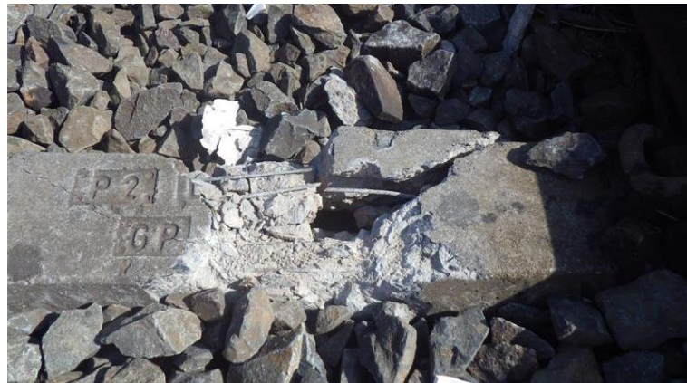
Şekil 2.70. Trenin yoldan çıkması sonrası traverste meydana gelen hasar (Anonim-g, 2019)
