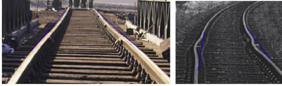
Şekil 2.34. Travers altındaki balast yatağındaki bozulmalar sonucunda meydana gelen geometrik hat bozulmaları (Sol-Sánchez ve ark., 2015)
