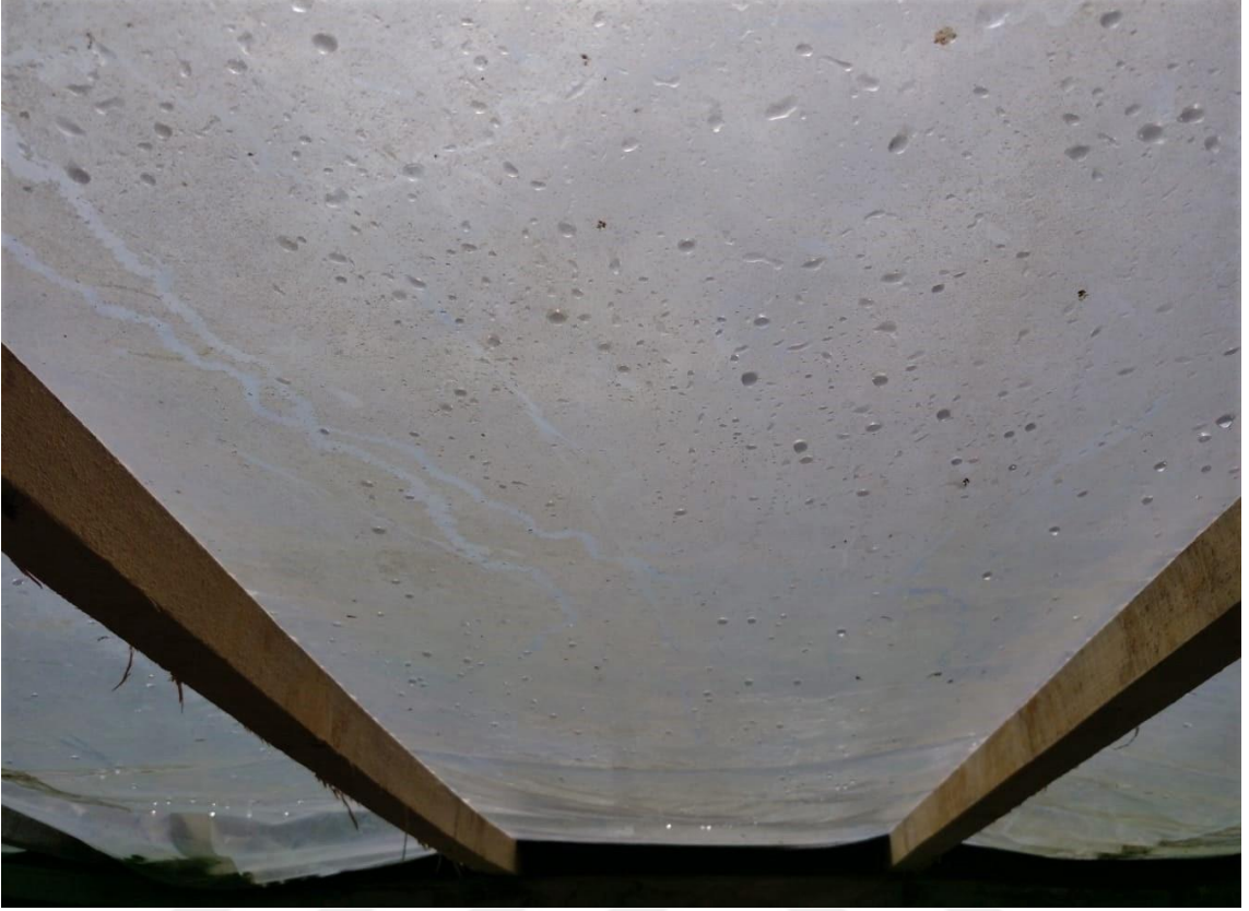
Şekil 4.9. Örtü iç yüzeyinde nem yoğunlaşması
