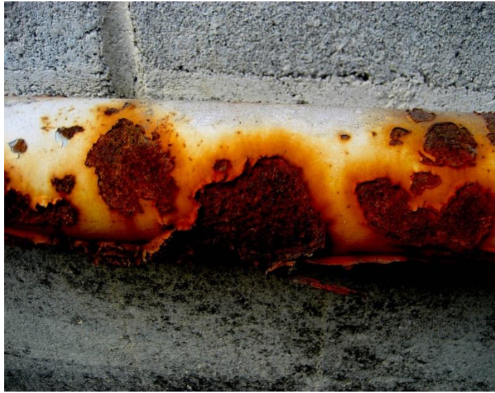
Şekil 2.1 Korozyona Uğramış Bir Boru Parçası
