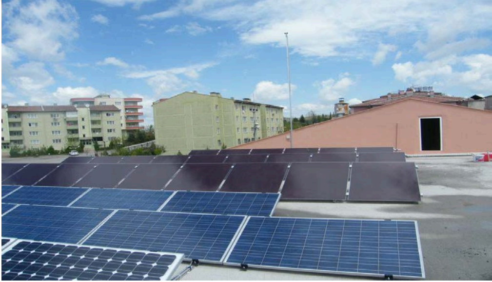
Şekil 3.5. Batman ili Özel Çözüm İlkokulunda kurulmuş 3 farklı modül teknolojisinden oluşan toplam 6.45 kWp gücünde fotovoltaik sistem
