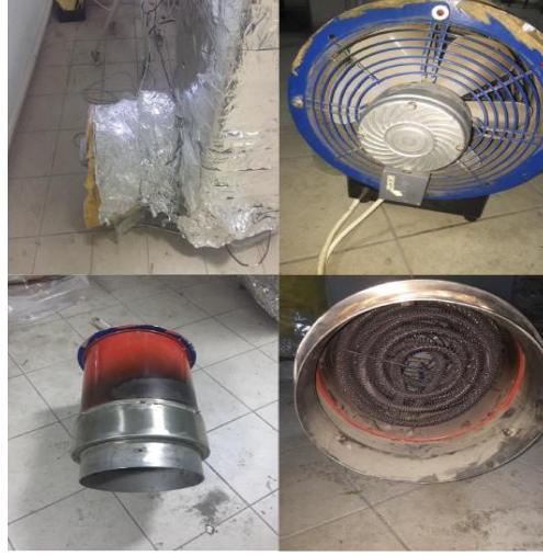
Şekil 3.4. Elektrikli ısıtıcı ve fan sistemi
