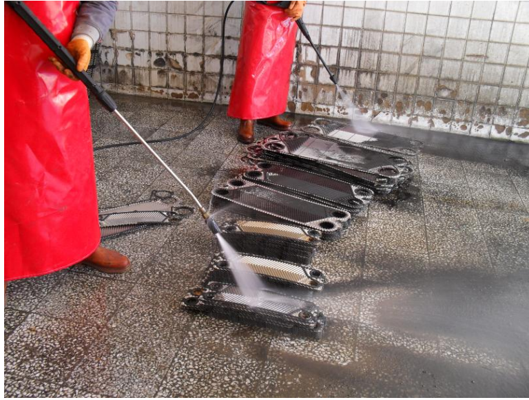
Őekil 1.14. Contalı plakalı ısı deęiřtirgeçlerinde kirlenme (fouling) ve temizlenmesi
