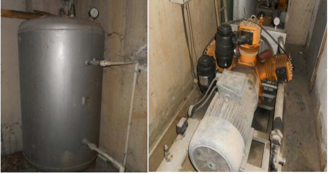
Şekil 3.11 : Hava Kompresörü ve Akümülatör Tankı
