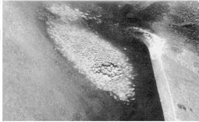
Şekil 1.11 : Kanatlar arası girdap kavitasyonu sebebiyle aşınmış Francis çarkı [28].
