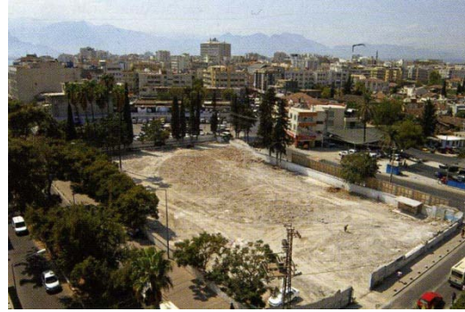
Picture 7.19 Okullar Bölgesi Yıkımdan sonra
