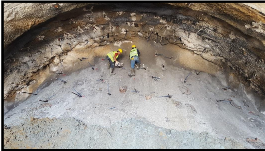
Şekil 4.29. 210+803,0 km arası oluşan göçük
