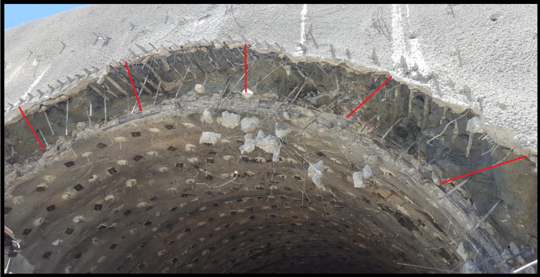
Şekil 4.12. İnceleme alanında tünel kesitindeki iksa ile zemin arasındaki deformasyon farkı
