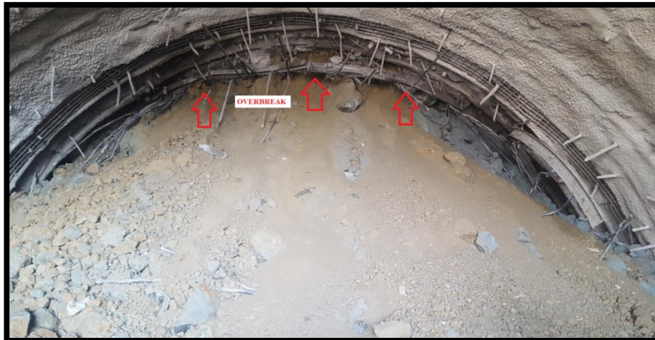
Şekil 4.52. İnceleme alanı T4 Tüneli ayna kazısı sırasında oluşan overbreak (aşırı sökülme)
