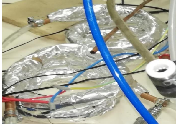
Şekil 4. 7. PEMYP Sisteminde Kullanılan Oksijen ve Hidrojen Gaz Hatlarının Isı Bandı
