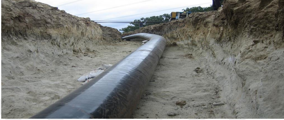
Şekil 2.2 Doğalgaz boru hattının görünüşü (BOTAŞ, 2018)
