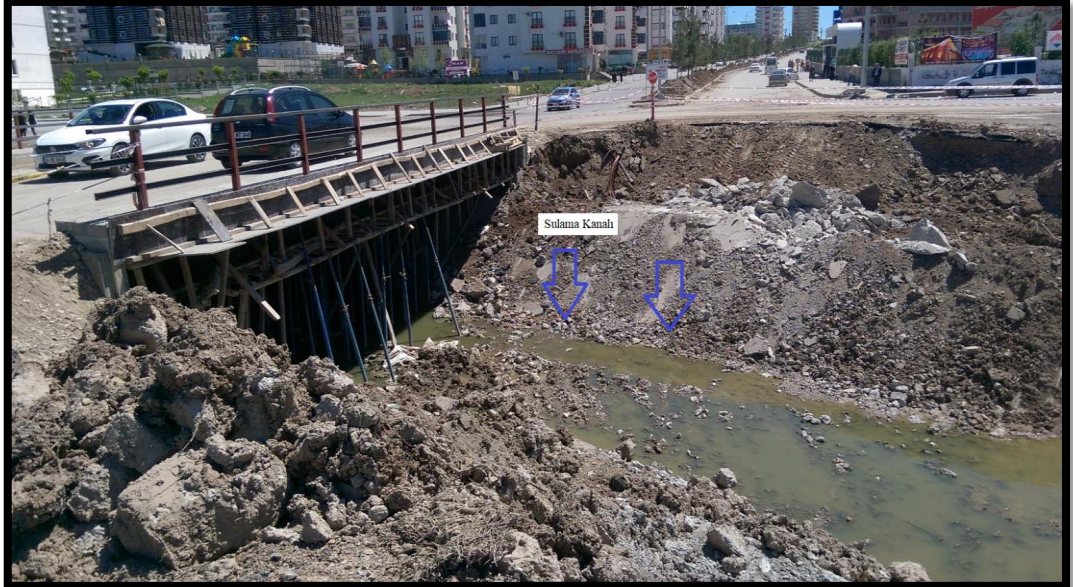
Şekil 5.2. İnceleme alanında bulunan sulama kanalı
