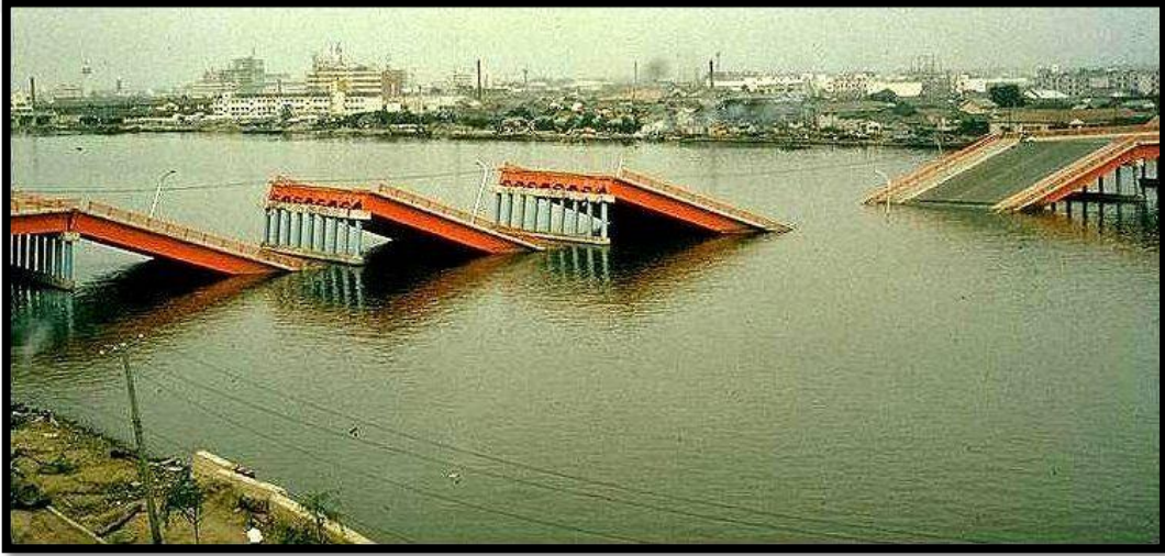
Şekil 4.10. 16 Haziran 1964 Niigata (Japonya) depremi sırasında çöken Showa Köprüsü. (Fotoğraf: EERC, University of California, Berkeley'deki Godden Collection'dan) ( https://www.usgs.gov/science-explorer-results?es=liquefaction )
