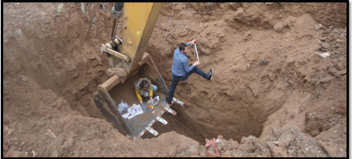
Şekil 5.17. Babil ve Serhat Apartmanları arasında kalan sahada açılmış olan araştırma çukuru açılma sırasındaki arazi çalışmaları
