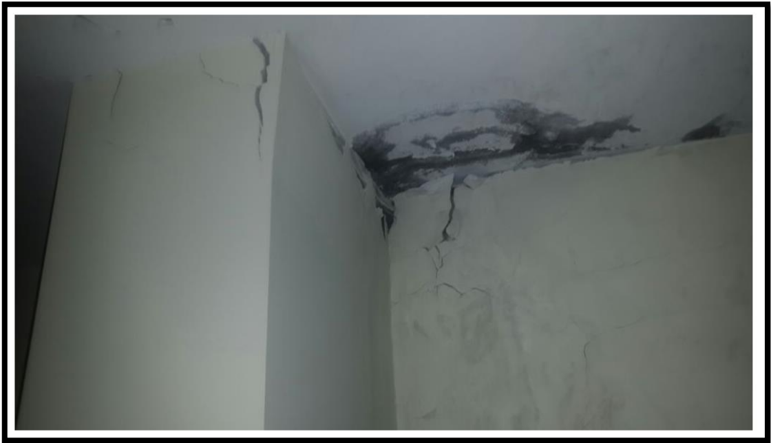
Şekil 5.8. Babil apartmanında gözlenen taşıma gücü ve oturma deformasyonları
