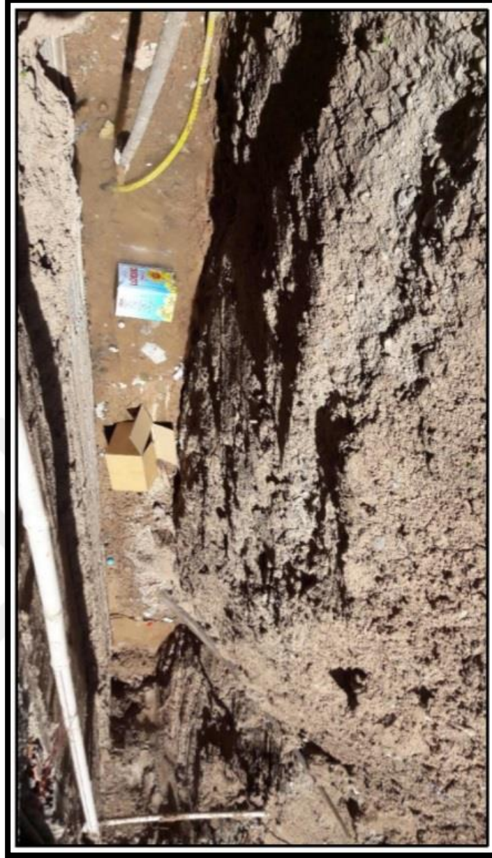
Şekil 5.28. Serhat Apartmanı bahçesinde açılmış kanal içinde 19.06.2017 tarihinde gözlenen yeraltı suyu
