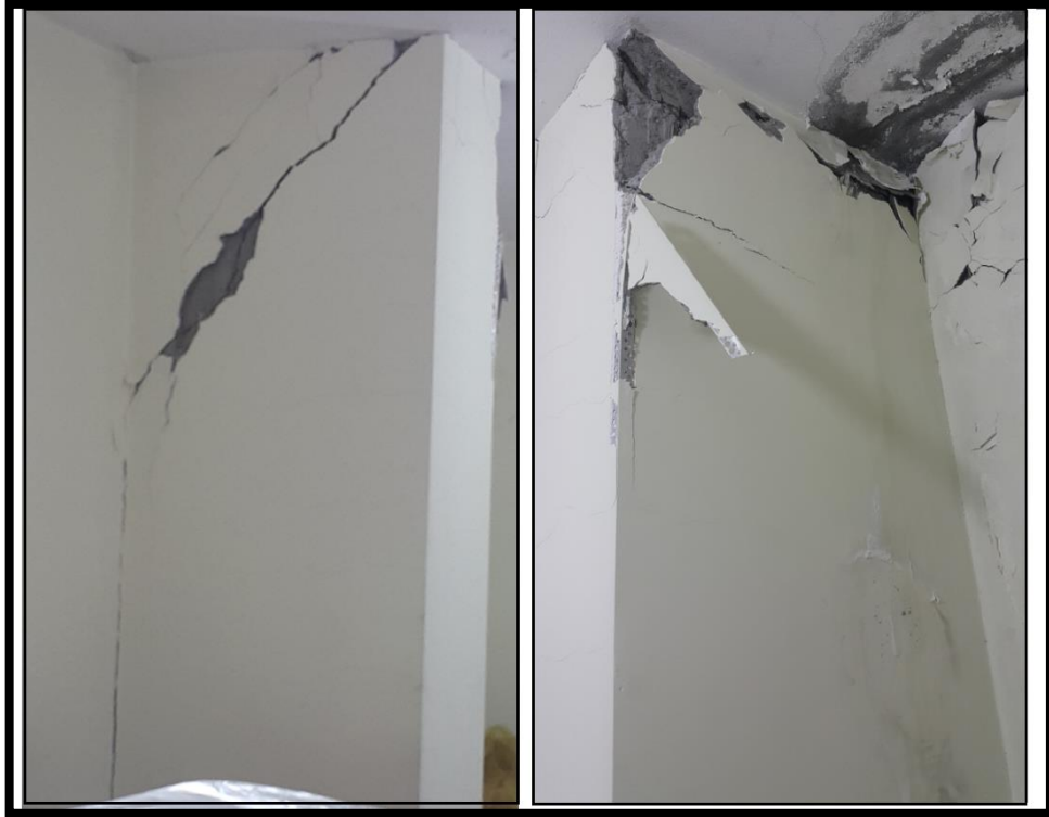
Şekil 5.10. Babil apartmanında gözlenen taşıma gücü ve oturma deformasyonları
