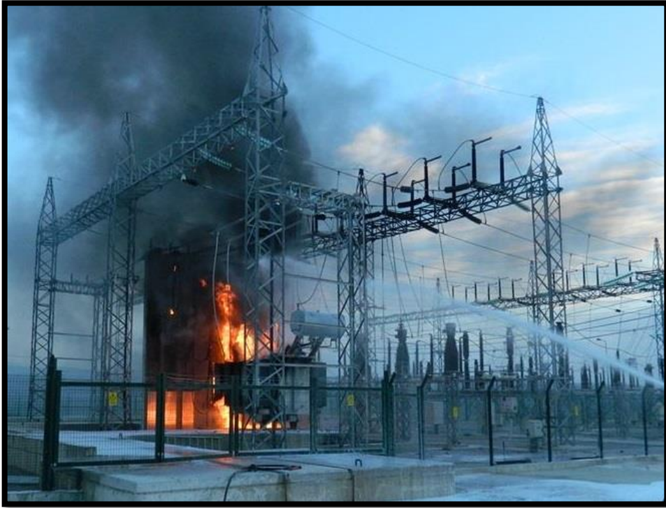
Foto 27: Kavak OSB'de Mayıs, 2014'te meydana gelen trafo yangını
