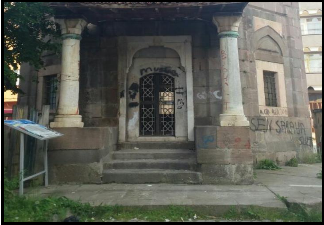
Foto 44: Sunullah Paşa Türbesi Koruma Sorunu Örneği (2), 2016
