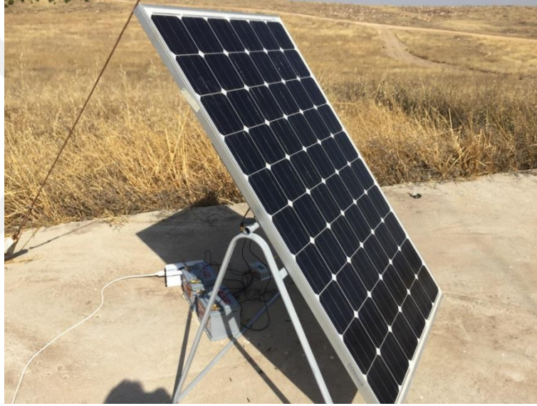
Şekil 3.13. Elektrik ihtiyacı için kullanılan Fotovoltaik (PV) Sistem
