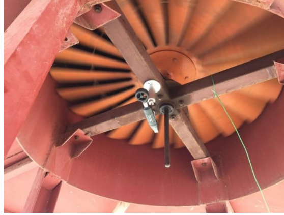
Şekil 3.20. Türbib girişindeki hava hızı ölçümü
