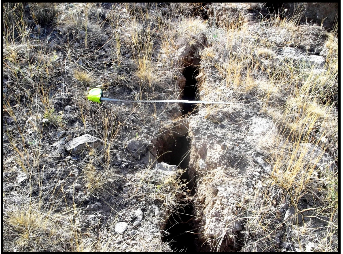
Şekil 46: Heyelan sahasında meydana gelen taş çatlakları yeni bir hareketin habercisidir.
