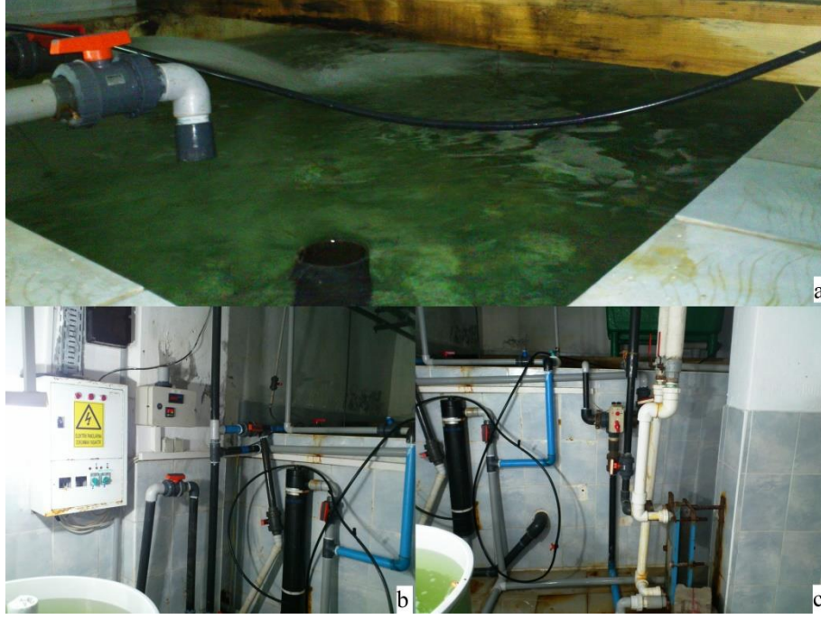
Şekil 4.3. DHATUÜ'ndeki beton su toplama havuzu (a), eşanjör sistemi (b) ve su dağıtım sistemi (c) (Orijinal)
