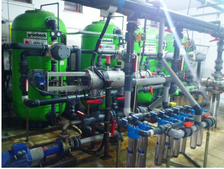
Şekil 4.2. SÜMAE'nün deniz suyu filtrasyon ünitesi (Orijinal)
