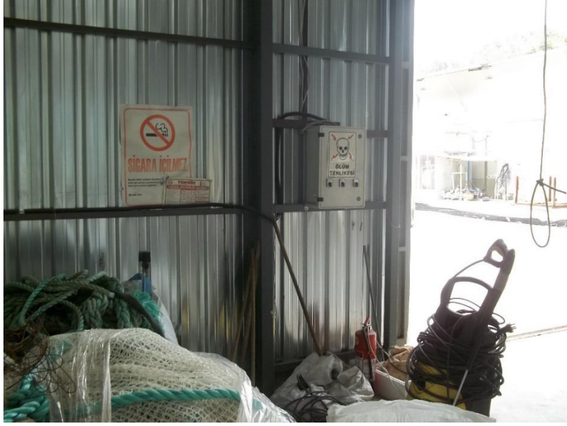
Şekil 5.1.3.10. Kapağı açık ve yalıtkan paspas bulunmayan elektrik panosu (Orijinal)
