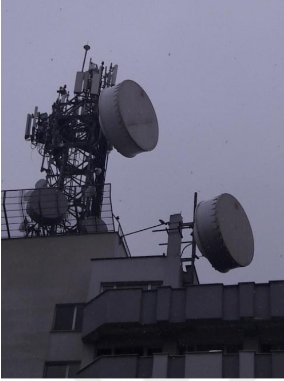
Şekil 4.5. PTT Binası Üzerinde Bulunan Antenler
