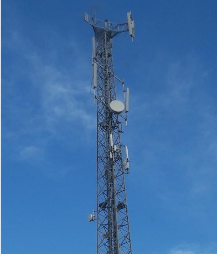
Şekil 4.22. Erfelek Yolu Üzerinde Bulunan Baz İstasyonu Kulesi
