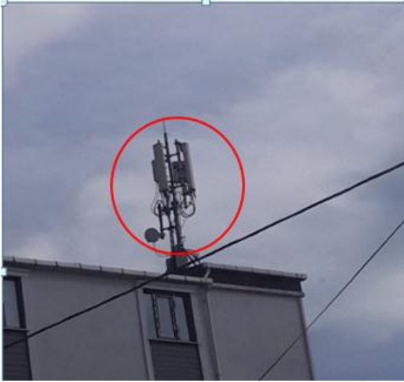
Şekil 4.8. Tarihi Cezaevine Yakın Mesafede Çatı Üzerinde Mevcut Baz İstasyonu
