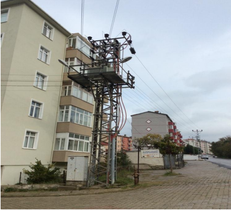
Şekil 6.1. Stat Yolu Üzerinde Trafo (Balkona Uzaklığı 5metre)
