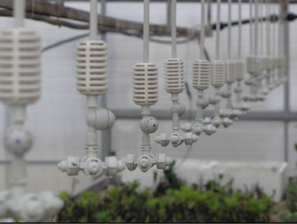
Şekil 3.1.2.1.2. Köklendirme serası sisleme ünitesi
