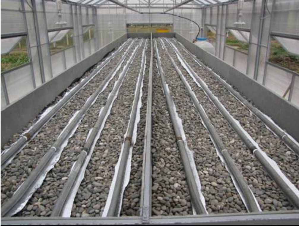
Şekil 3.1.2.3.1. Köklendirme tavaları ve ısıtma boruları
