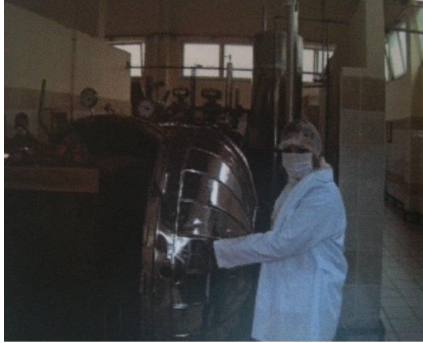
Şekil 3.10. Tıbbi atık sterilizasyon tesisi.
