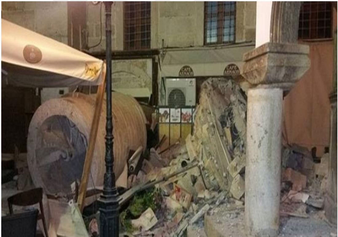
Şekil 1.20. Ege Denizi'nde meydana gelen deprem sonucu İstanköy Adası'nda yıkılan minare (Anonim, 2017)
