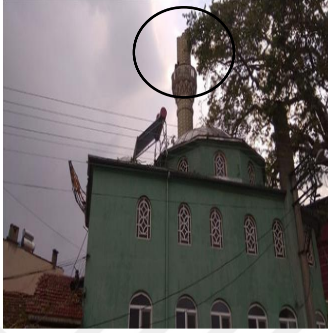
Şekil 1.17. Balıkesir’de aşırı yağıştan yıkılan minare (Anonim, 2018)
