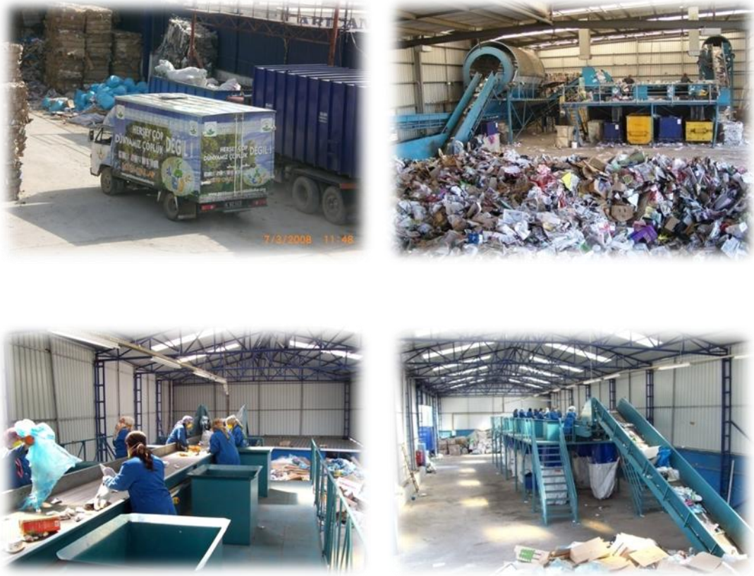
Şekil 3.5 Ambalaj Atıkları Toplama Ayırma Tesisi
