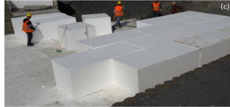
(c) Geofam blok – geofam blok ara yüzeyi (Yer: Acıbadem, İstanbul; Fotoğraf: Emre Akınay, Tarih: 10.03.2017)
