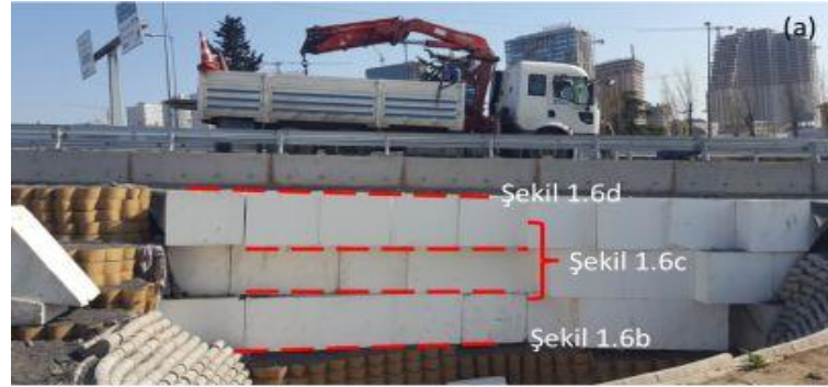
(a) Geofam blok yol dolgusunun kesiti (Yer: Acıbadem, İstanbul; Fotoğraf: A. Tolga Özer, Tarih: 14.04.2017)
