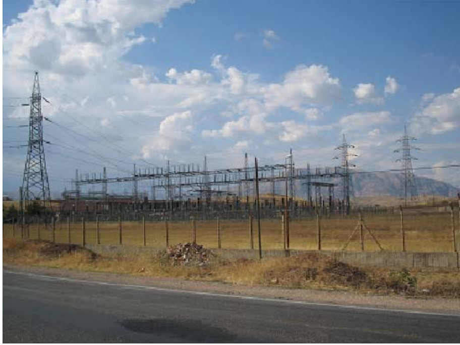
Fotoğraf 16: Gölbaşı Elektrik Dağıtım Şebekesi
