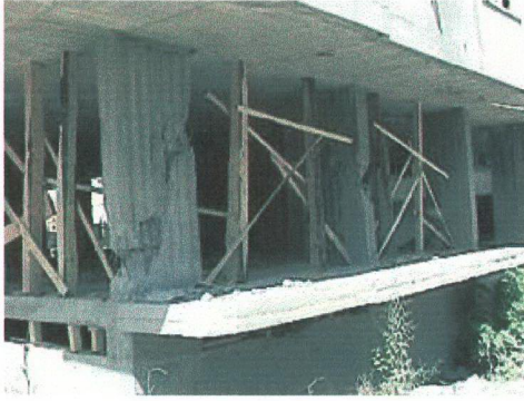
Foto 4.13 Henüz inşaat aşamasında bir yapı ve zemin kat kolonlarında kesme hasarı (Bayülke-DAM, 1998)
