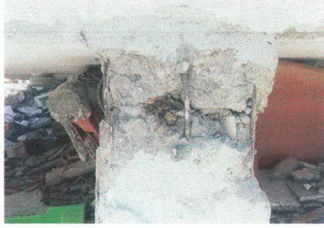
Foto 4.7 Hasevler'den bir kolon detayı (Bayülke-DAM,1998)
