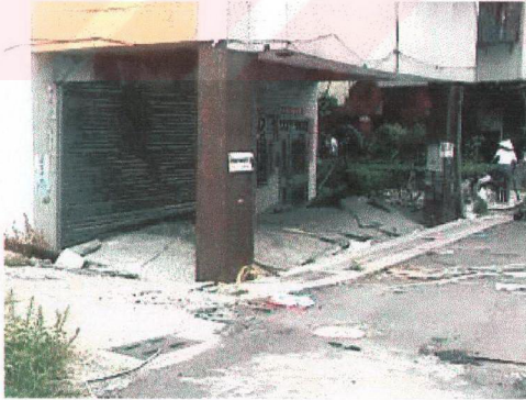
Foto 3.36 Dört katlı bu binanın zemin kat kolonları sıvılaşmadan dolayı zemine 50 cm. gömülmüştür, Tayvan Depremi. (EERI)
