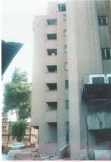
Resim 4.17. Telekom Lojmanı, kalkan duvar yıkılması bir çocuğun ölümüne neden olmuştur (Bayülke-DAM, 19989)
