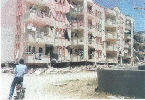
Foto 4.6 Tehlike katı, kolonlarda kesme dayanımı yetersizliği, Hasevler Yapı Kooperatifi Cumhuriyet Mahallesi, (Bayülke-DAM, 1998)
