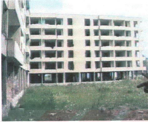
Foto 4.5 Tehlike katı, kötü zemin, aynı yönde tasarlanmış kolonlar; Sonuç: ağır hasar, yıkım kararı (Gökçe, 2002)
