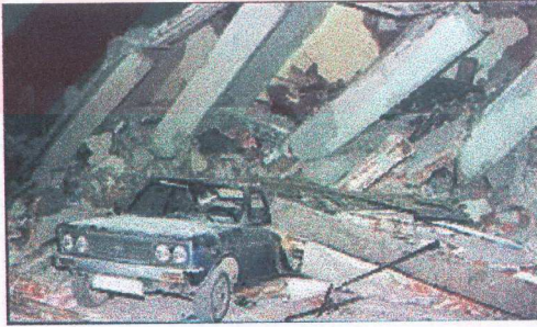
Foto 3.10 Kat kolonlarının mafsallaşmasıyla oluşan iskambil kağıdı etkisi, 17 Ağustos 1999 İzmit Depremi, M=7,4
