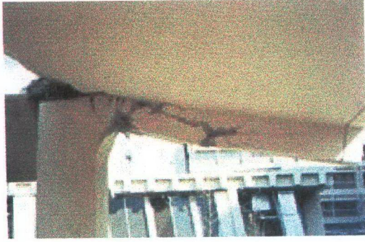
Foto 3.8 Olive View Tıp Merkezi, konsolda ankraj yetersizliđi
