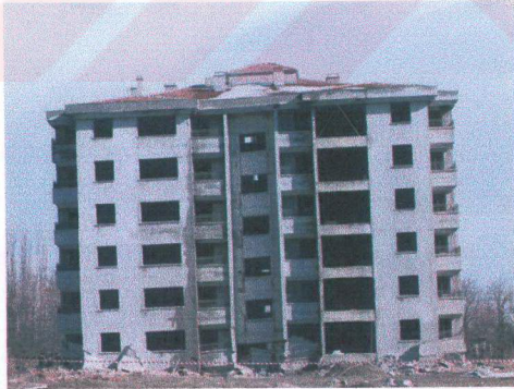
Foto 16 Aynı kooperatif bloklarından alüvyon zemine gömülmüş, ağır hasarlı diğer blok (Gökçe, 2002)
