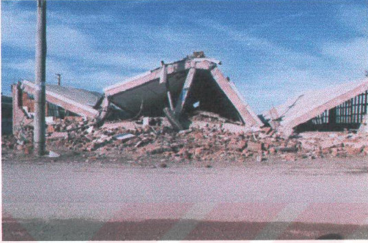
Foto 5 Çay Sanayi Sitesi, zayıf kolon-ađır dōşeme, donatı miktarı ve ankraj yetersizliđi, beton kalitesizliđi, alüvyon zemin (Gökçe, 2002)
