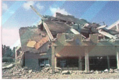
Resim 3.48 . Galerie Algerienne binası, 4 katlı yapı, kolon kiriş bağlantıları yetersizliği. Domino taş etkisi, 1980 Cezayir El Esnam Depremi (EERI)
