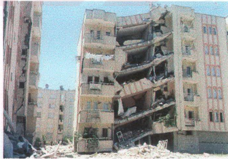
Foto 4.8 Bloğun sağ yanındaki dolgu duvarı kendi üstünde yıkılmayı önlemiştir (Bayülke-DAM, 1998).
