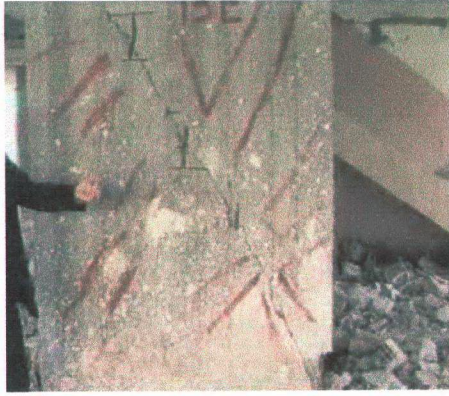
Foto 4.11 Yetersiz etriye, kalitesiz beton, kolonda kesme hasarı (Gökçe, 2002)
