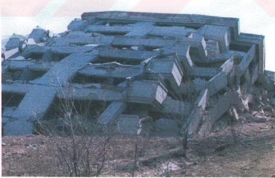
Foto 12 Çay İlçesi, Yeşilçay Kooperatif binalarından yıkılan blok, alüvyon zemin, rezonans etkisi, kalitesiz beton, kalitesiz demir işçiliği (Gökçe, 2002)
