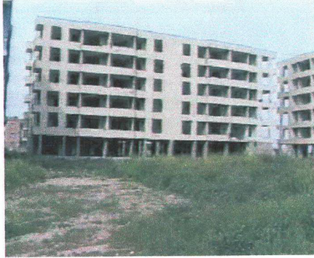
Foto 4.4 Eski nehir yatağı dolgu zemin üzerine yapılmış bir kooperatif binası (Gökçe, 2002)
