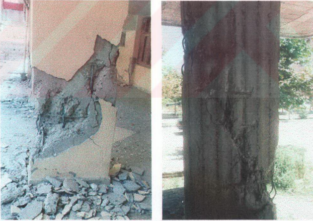
Foto 4.14 İki ayrı yapıya ait kolon hasarları ( Bayülke-DAM, 1998)
