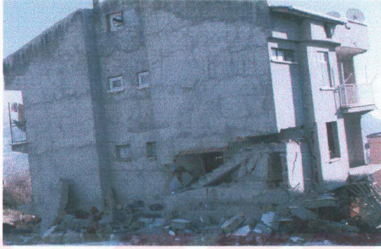
Foto 11 Çay İlçesi , ağır hasarlı yığma bir bina, merdiven rijitlik merkezi oluşturarak burulma etkisi doğurmuş (Gökçe, 2002)
