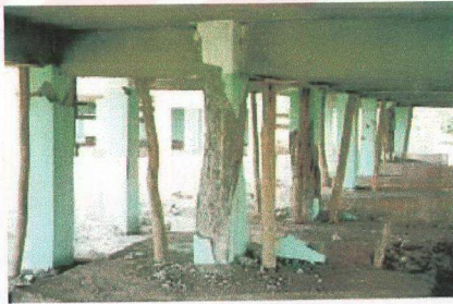
Foto 3.9 Kademeli kolonlar, çürük zemin, tehlike katı, C plan bu yurt binasında birleştirilmiştir, 22 Mayıs 1997 Jabalpur Depremi, Hindistan (EERI)
