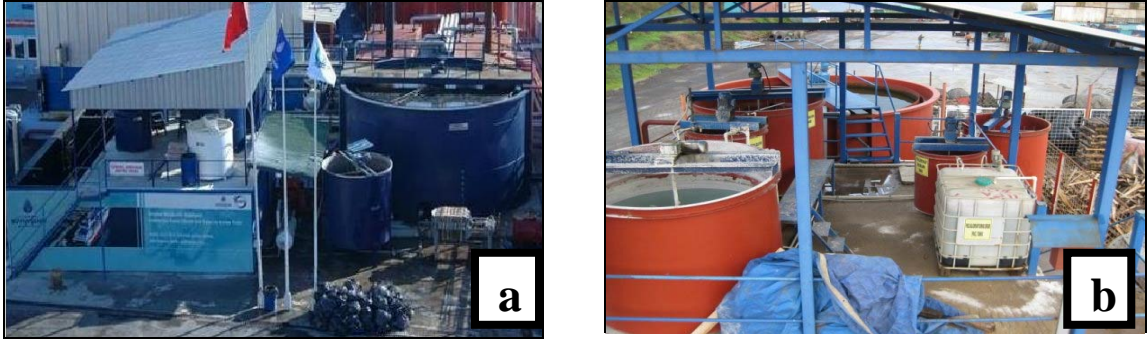
Fotoğraf 3.8 Haydarpaşa (a) ve Martaş (b) Limanı AKT arıtma tesisleri
