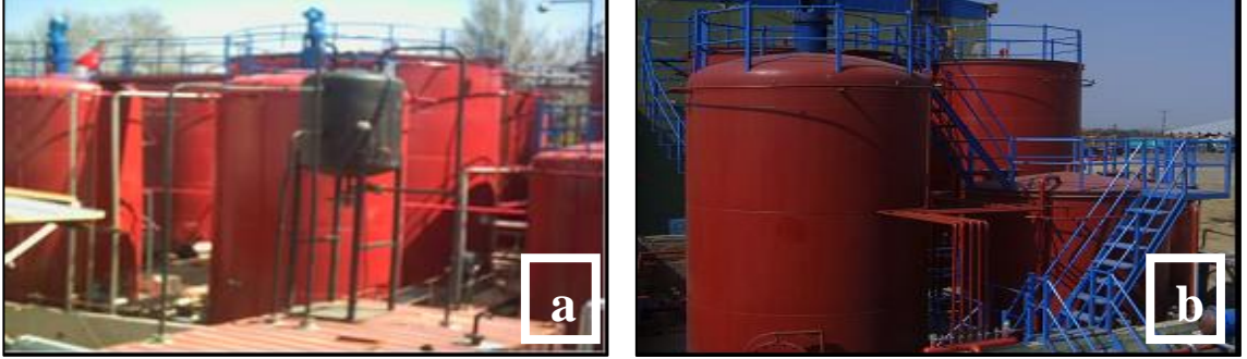
Fotoğraf 3.5 Haydarpaşa Limanı AKT (a) ve Martaş Limanı AKT (b) depolama üniteleri
