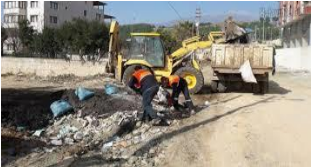
Foto 7 –Antakya İlçesi'nde Altyapı Çalışmalarından Oluşan Görüntü Kirliliği
