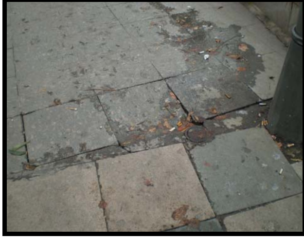
Şekil 4.4.b Eminönü hasarlı döşeme elemanı örneği [Özgün]
