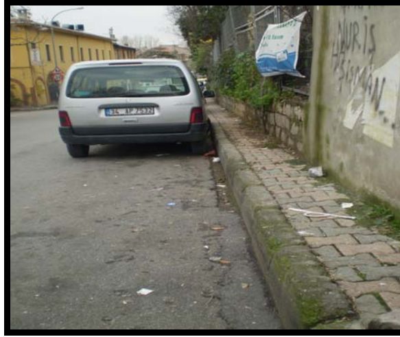
Şekil 4.10. Bağlarbaşı olumsuz kaldırım örneği [Özgün]
