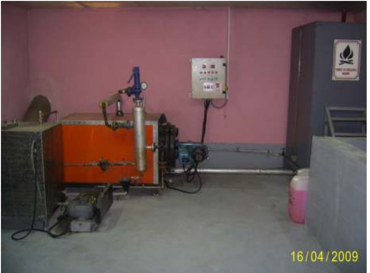
Şekil 3.8 Boiler Odası, Edirne
