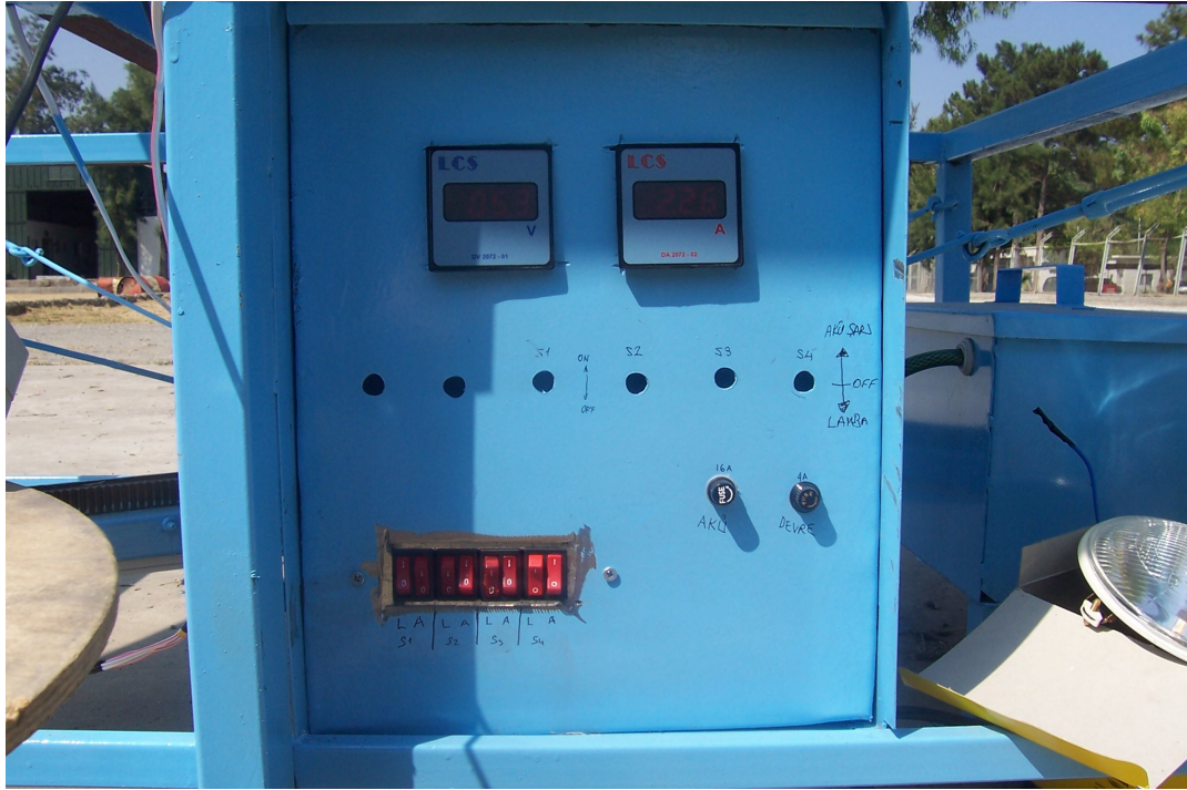
Şekil 3.13. Dijital Göstergeli Ampermetre ve Voltmetre
