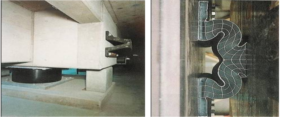
Şekil 3.10. İzolatör katı seviyesinde yapının deprem esnasında dış perdelere çarpması durumunda, yapının zarar görmemesi için yanlara yerleştirilmiş kauçuk tamponların görünümü
