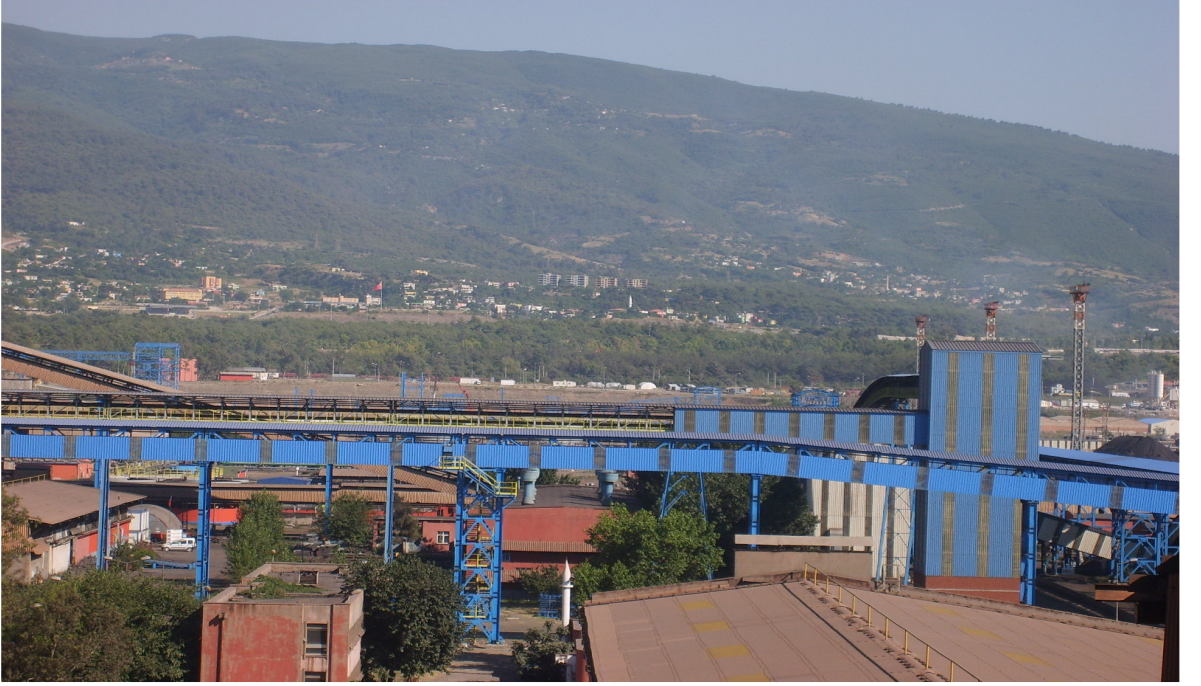
Şekil 4.2. Liman-Kömür stok sahaları arası konveyörler
