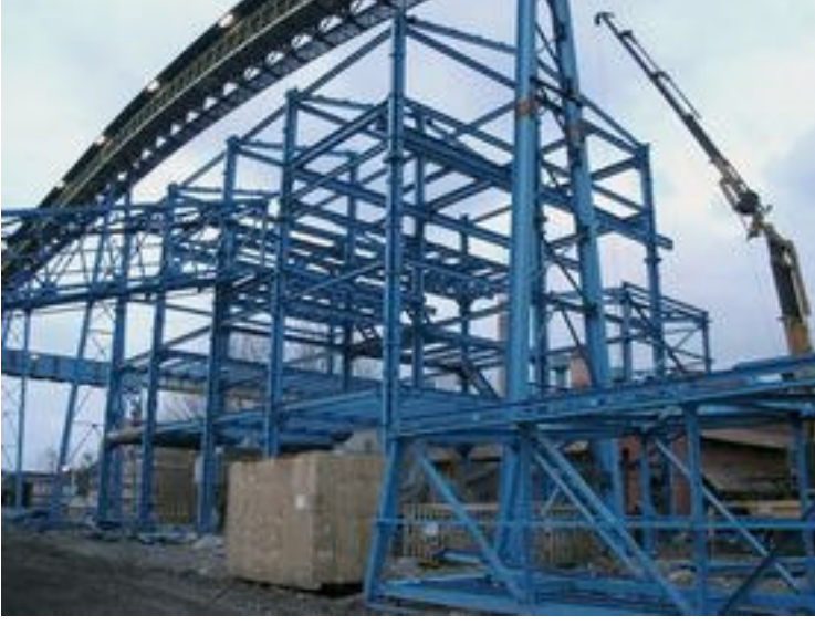
Şekil 4.4. Yeni Yapılan Konveyör Hatları
