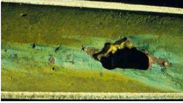
Şekil 1.6. Erozyon Korozyonu (www.cheresources.com)
