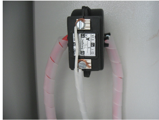
Şekil 3.18 Panodaki akım trafosu
