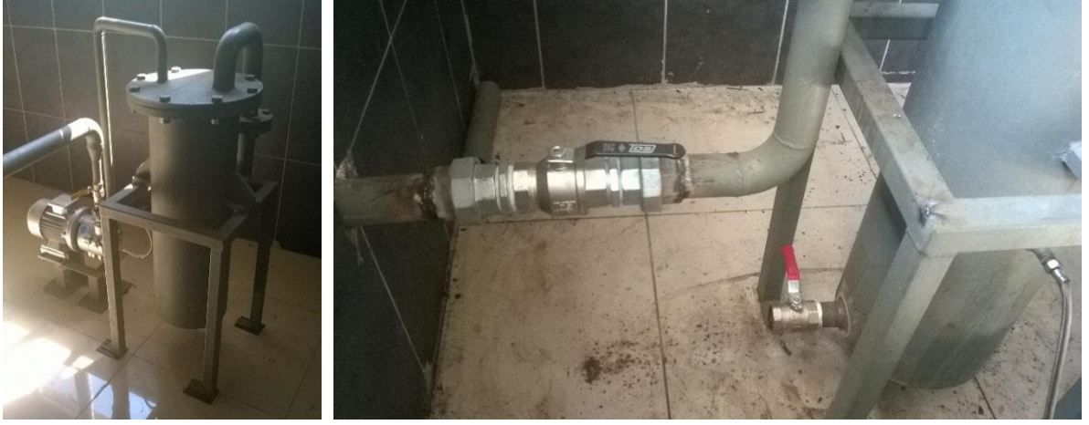
Şekil 3. 14. Vakum pompası, pompa servis suyu deposu ve çıkış hattı
