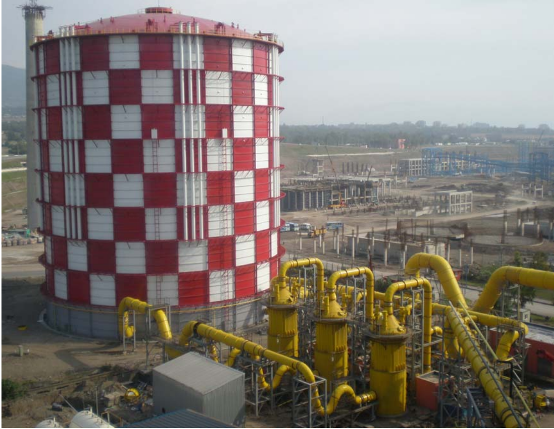
Şekil 4.2. İSDEMİR konverter gazı kazanım tesisi
