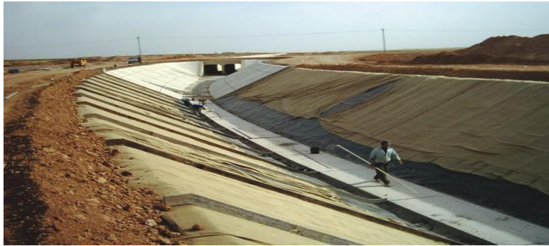
Şekil 4.21. Yüzey Suyu Drenajı
