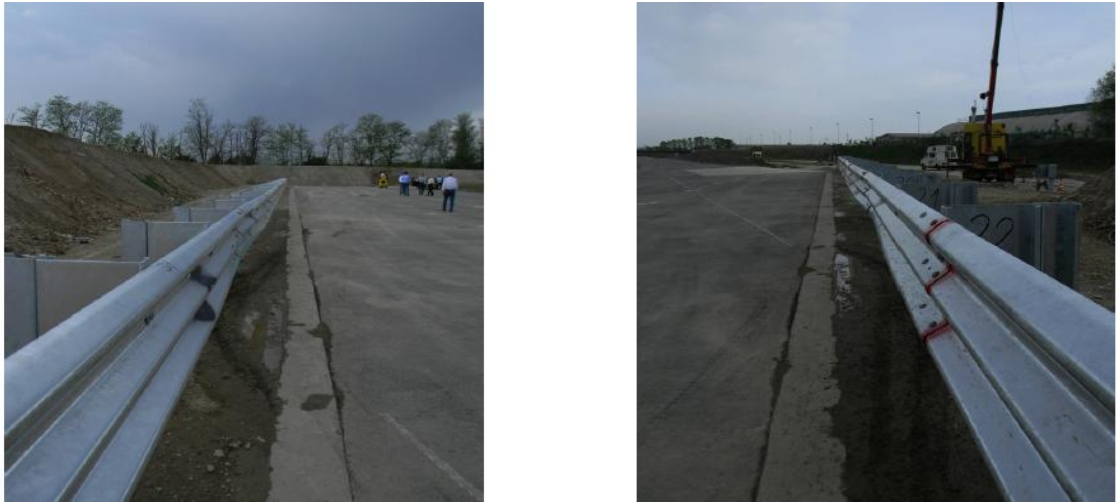
Şekil 4.5. TB11 Testi Sonrası Deforme Olmuş 3N AHO Otokorkuluğunun Yan Görüntüsü
