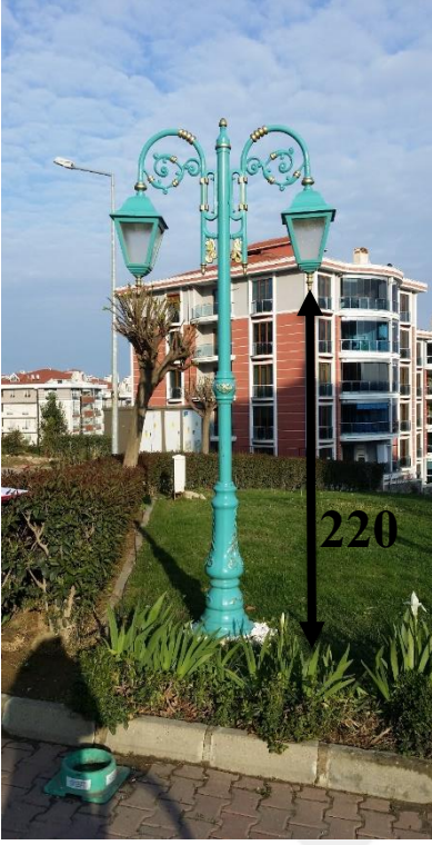
g.) Hürriyet Mah. Süleymanpaşa Parkı aydınlatma elemanı
