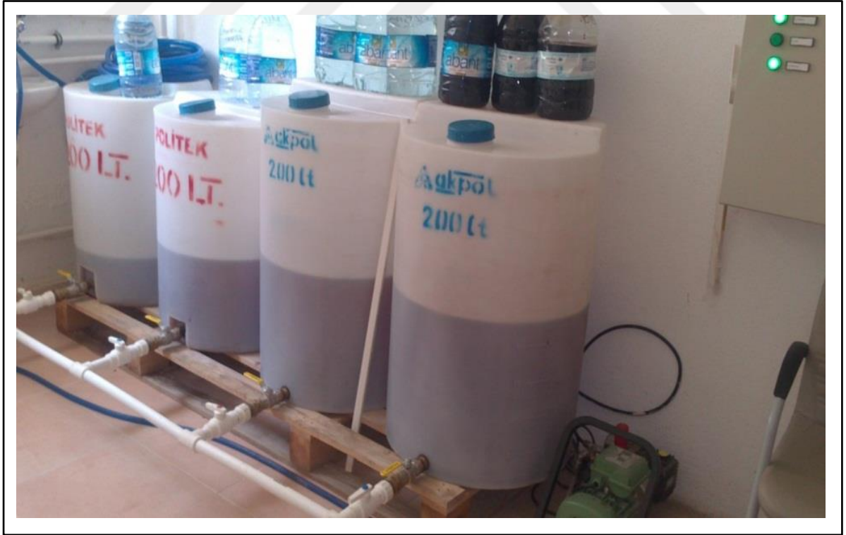
Şekil 3.3. 200 litre hacmindeki besin çözelti ile doldurulan hidroponik tanklarının görünümü
