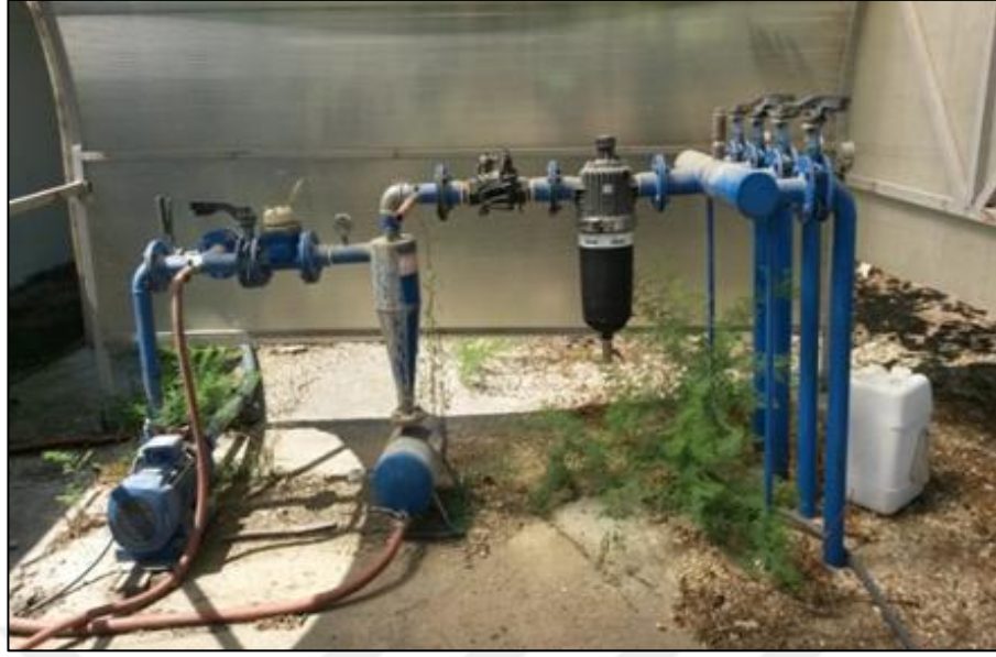
Şekil 3.4. Damla sulama sistemi kontrol birimi
