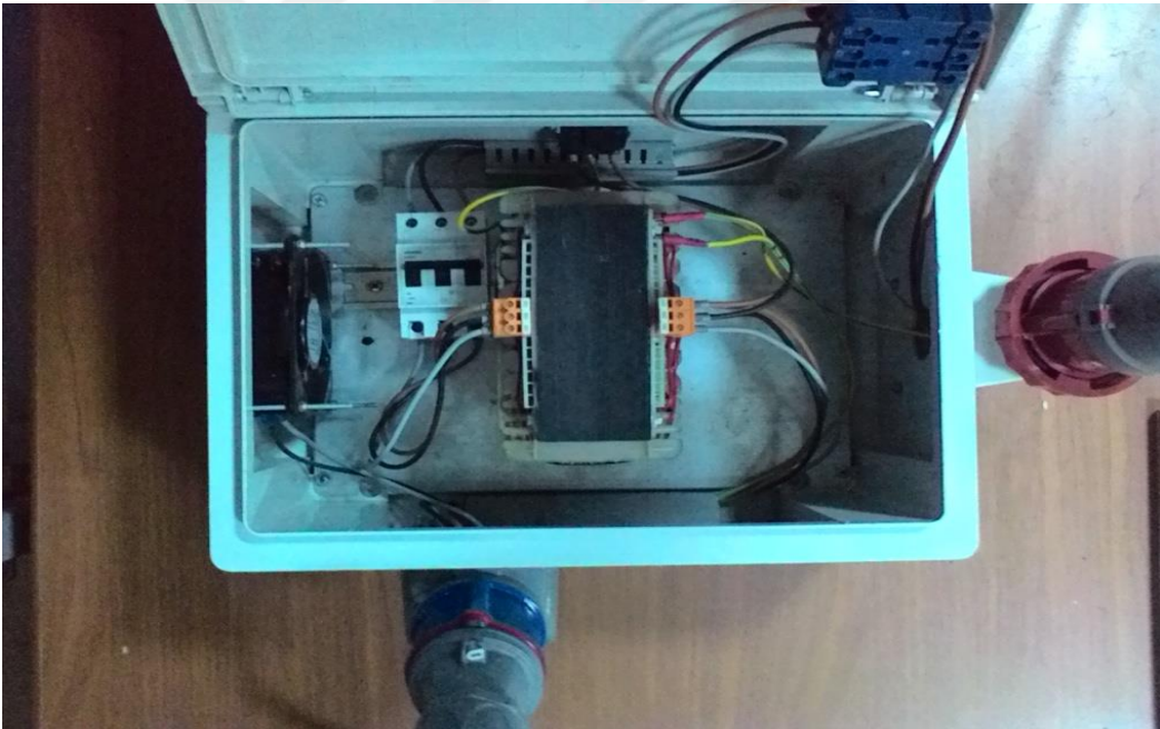
Şekil 6.35 Hat Dönüştürme Birimi İç Görünüm
