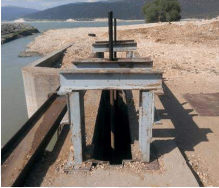
Şekil 4. Gölde bulunan tahliye kapakları
